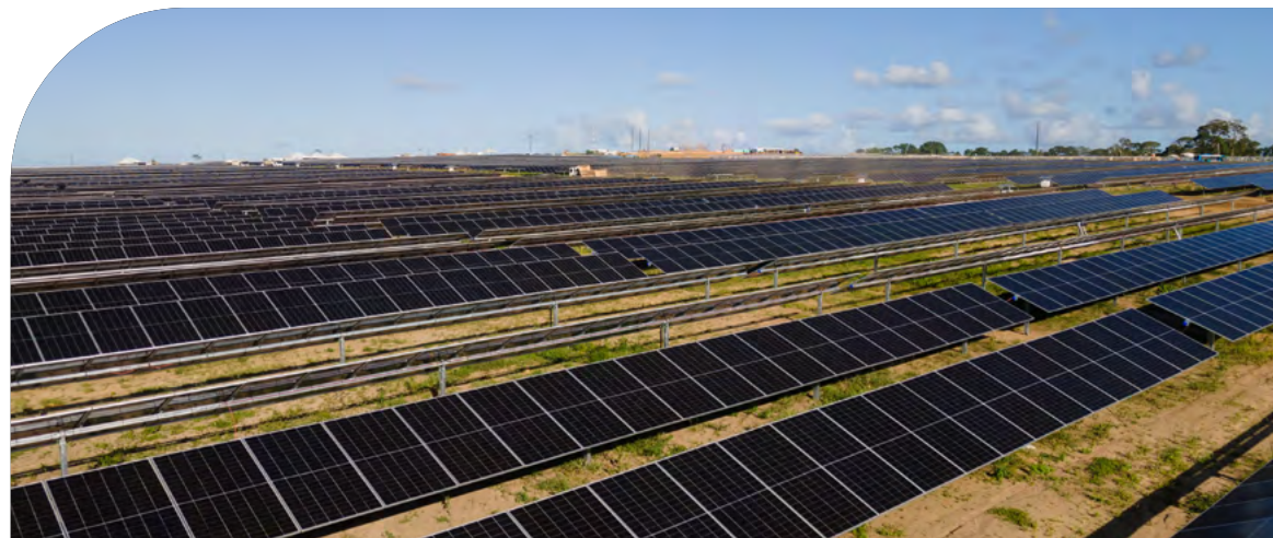
Complexo Fotovoltaico Maravilhas (PE) - Atiaia Renováveis
